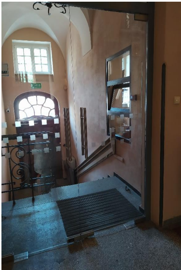
Zdjęcie 5 Brak oznakowania przeszkleń w budynku sądu.
